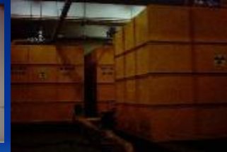
地下三樓廢水儲存槽
